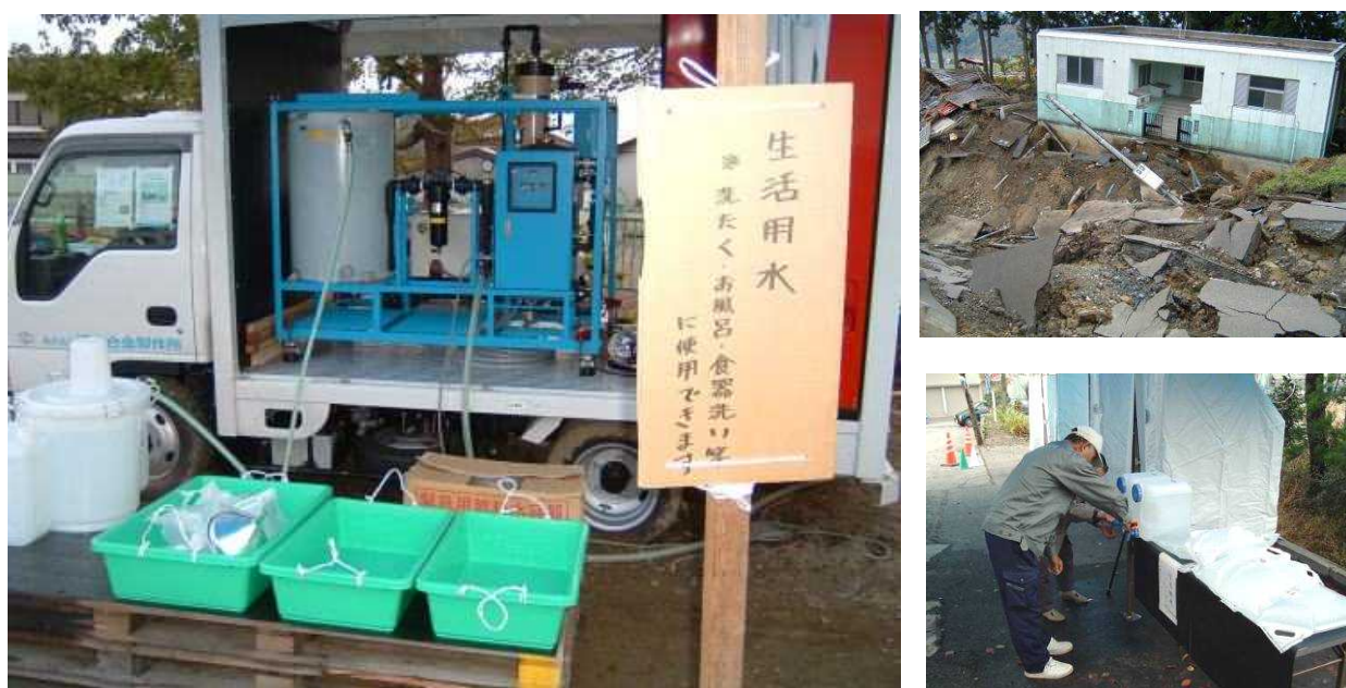
図13. 災害発生時の仮設給水としての運用事例
